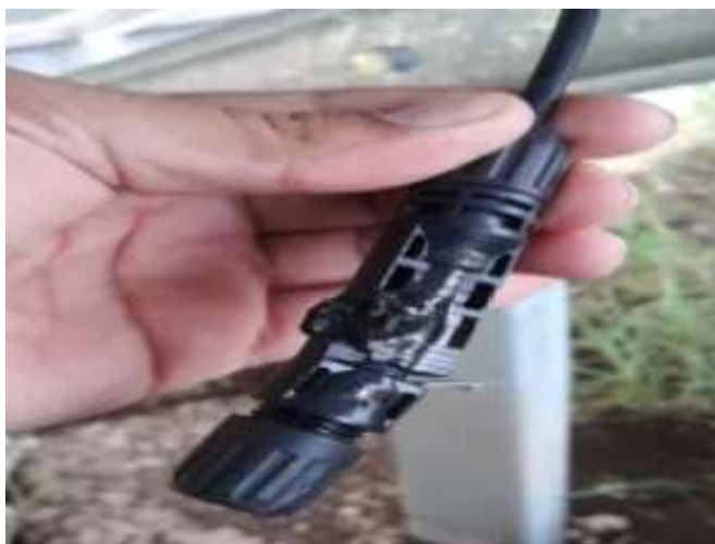
Σχήμα 53. Σύνδεσμος που κάηκε λόγω ασυμβατότητας
