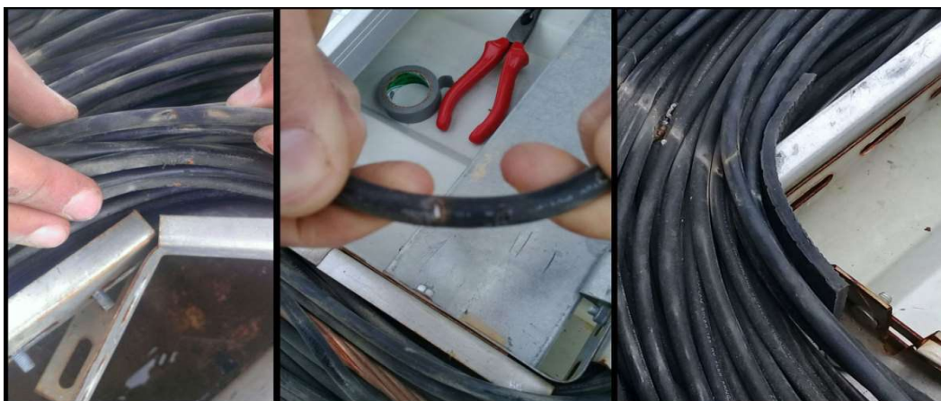
Σχήμα 61. Φθορές καλωδίων και καλωδίωσης
