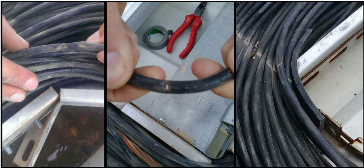
Şekil 61. Kablo ve kablolama hasarları
